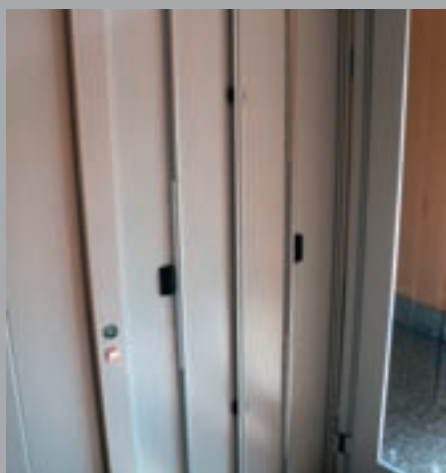
porte di cabina a soffietto
